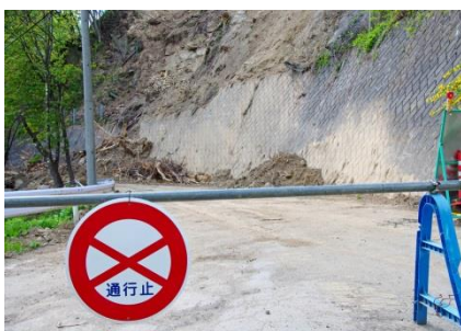
無人危険箇所の状況監視
